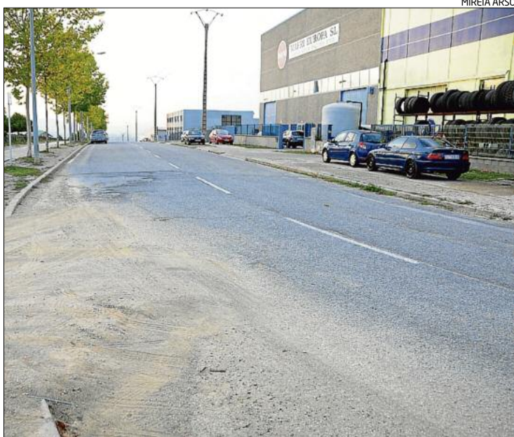
Paviment en mal estat a Bufalvent. Els polígons volen més manteniment
